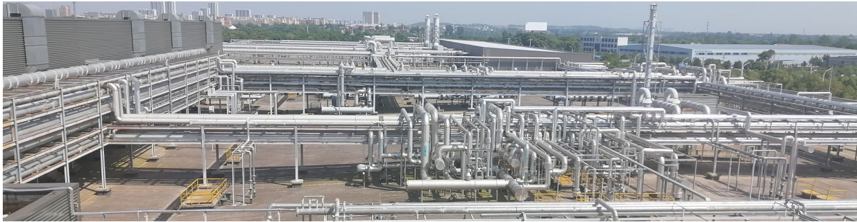
● 京东方武汉第 10.5 代 TFT-LCD 生产线废水处理装置
