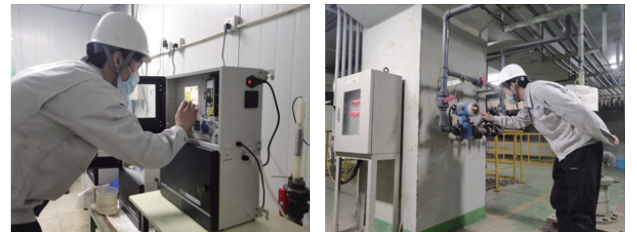
员工正在检查仪器仪表以及各加药系统
